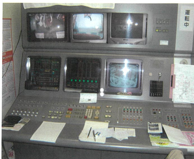
プラント操作室
